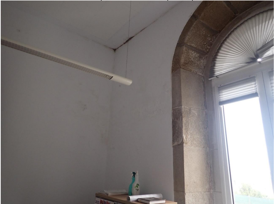
Vista del despacho afectado en planta primera
