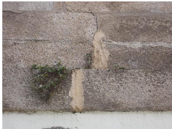
Fig.26. Reparaciones inadecuadas de encintados en cuerpo adosado de aseos y vegetación en superficies horizontales.
