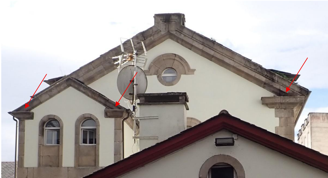
Fig.22. Proliferación de vegetación y posible acumulación de agua en superficies horizontales.
