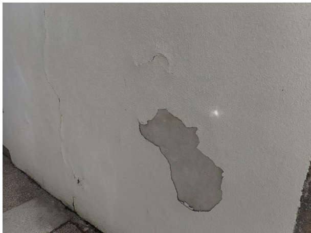
Fig.25. Desconchado en mortero en cuerpo adosado de aseos
